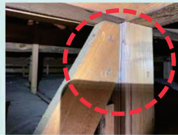
耐震金具がない
