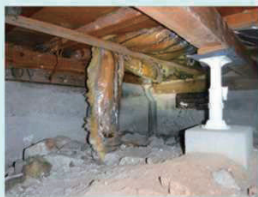
床下断熱材の剥離
